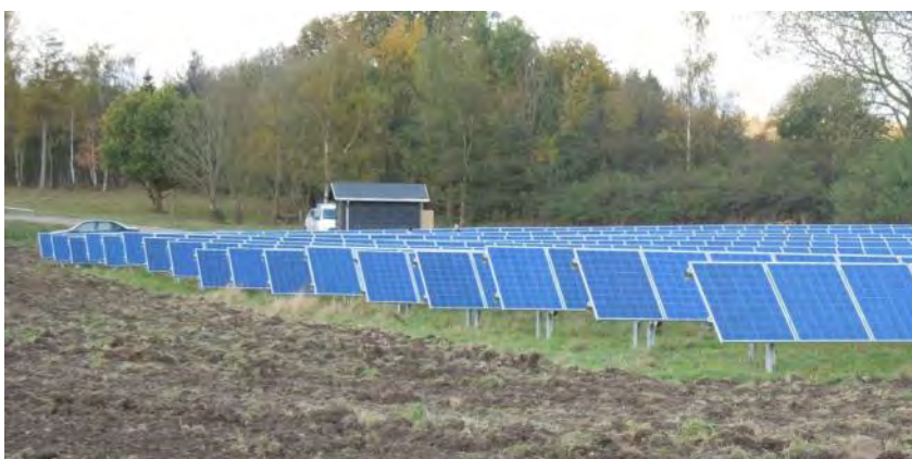
Figur 1 Eksempel på markopstillet solcelleanlæg
